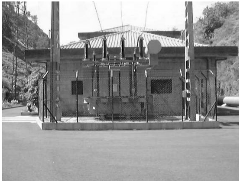
Transformador de potencia
